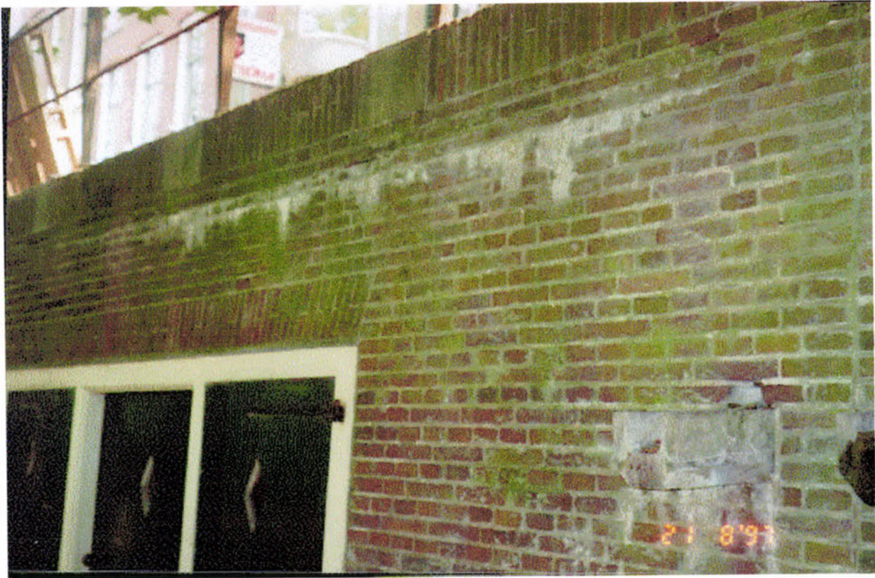
W0445-02 Lekkend metselwerk en begroeiing op metselwerk
