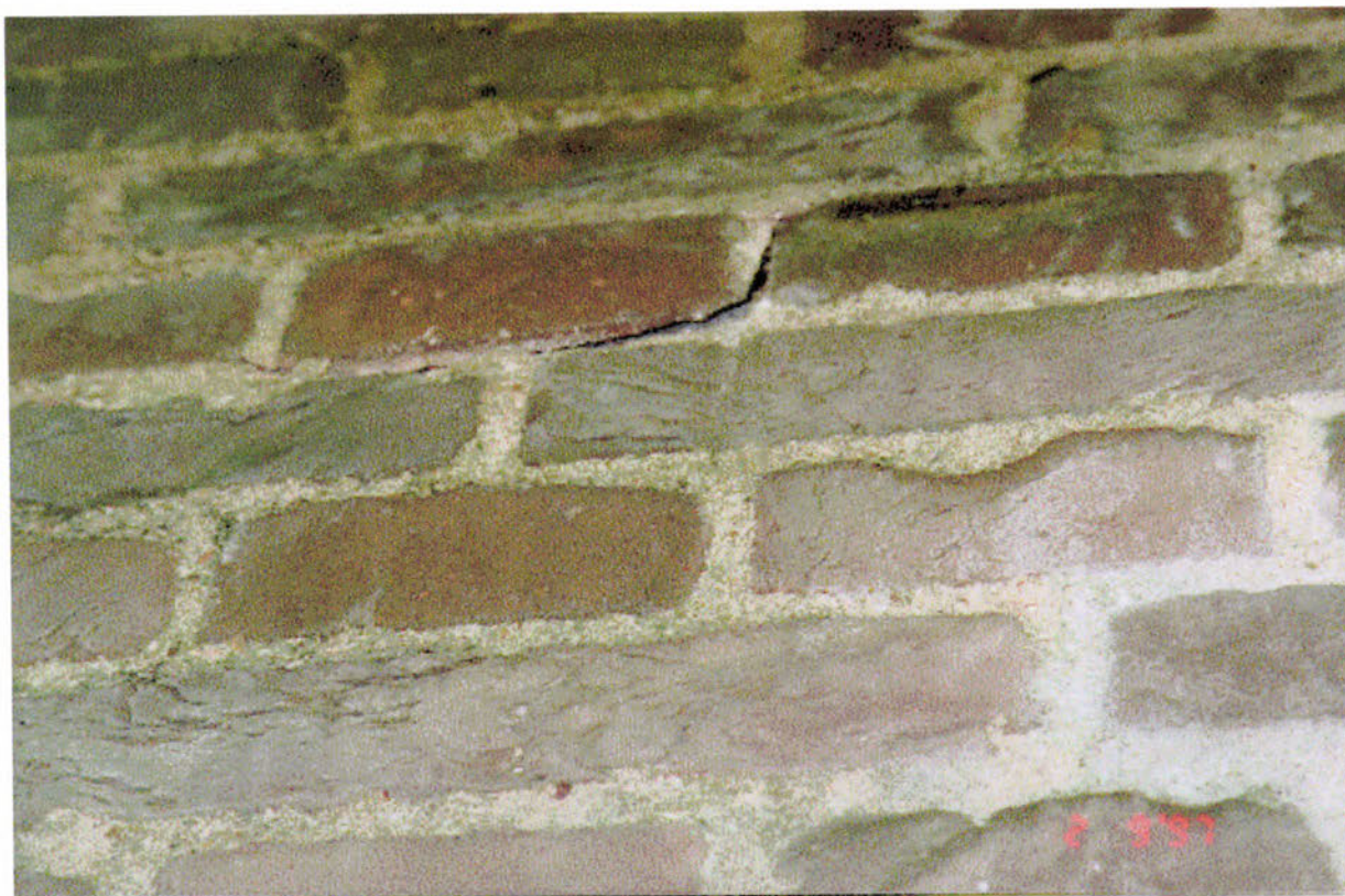
W0217-01 Scheur in metselwerk
