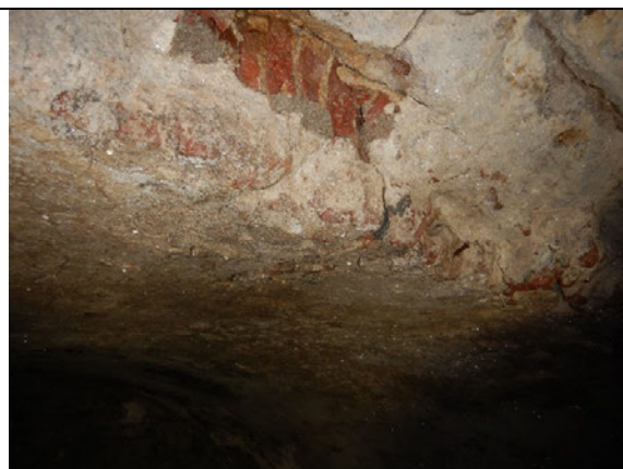
Foto 2: deformatie / verzakking gewelf
