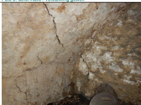
Foto 5: scheur in het gewelf en de achterwand, scheur nr. 4
