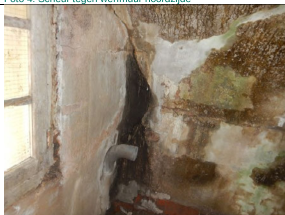
Foto 6: Scheur tegen werfmuur zuidzijde
