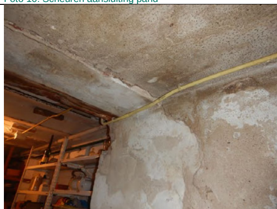
Foto 12: Scheuren aansluiting pand
