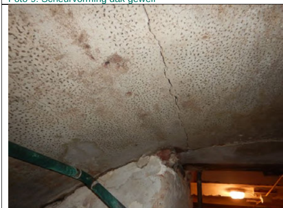
Foto 11: Scheuren aansluiting pand
