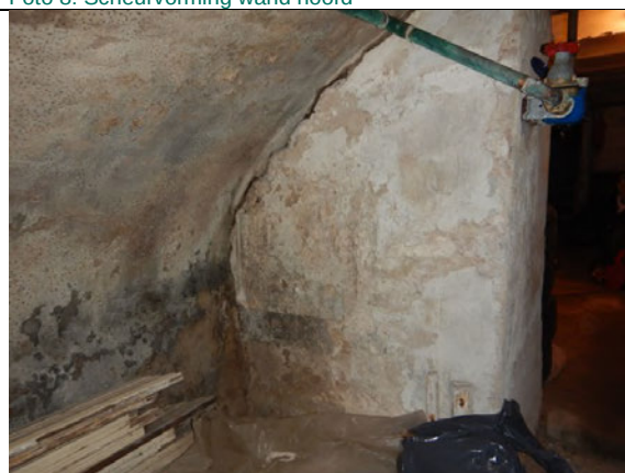
Foto 10: Scheuren aansluiting pand
