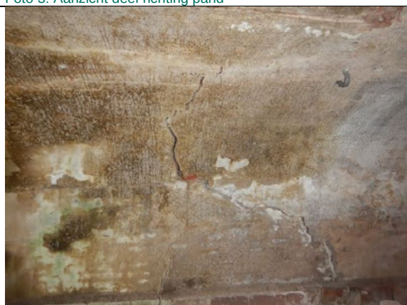
Foto 5: Scheur wand zuidzijde
