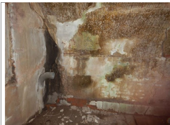
Foto 7: Scheuren en schimmels
