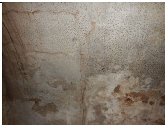
Foto 8: Scheurvorming wand noord
