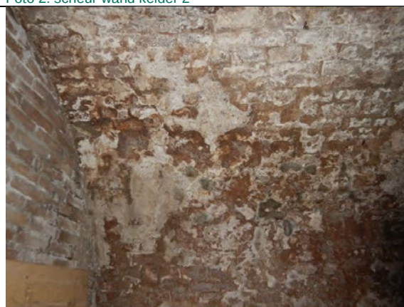
Foto 4: Vocht en los voegwerk
