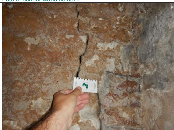
Foto 5: forse scheur kelder 3
