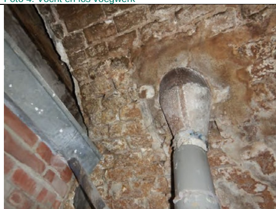
Foto 6: losse stenen rondom doorvoer kelder 3
