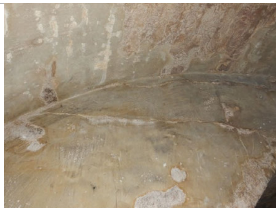
Foto 2: scheur wand kelder 2
