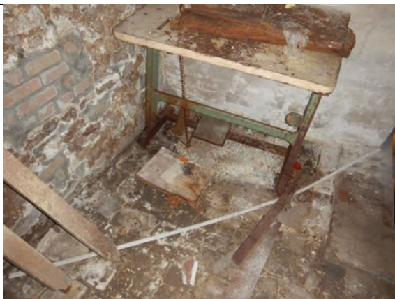
Foto 8: vochtige vloer kelder 3
