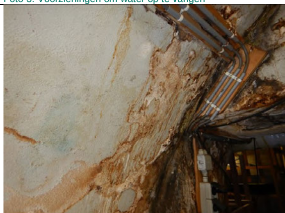
Foto 5: Schimmels en zwammen op de wanden
