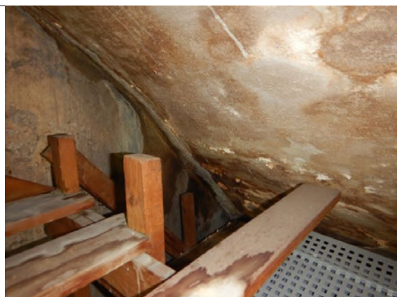
Foto 1: Zichtbaar lekkages in de wanden
