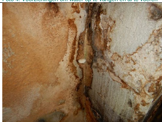
Foto 6: Schimmels en zwammen op de wanden
