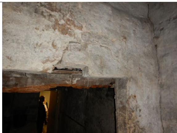
Foto 7: tussenwand ruimte 2 losse stenen
