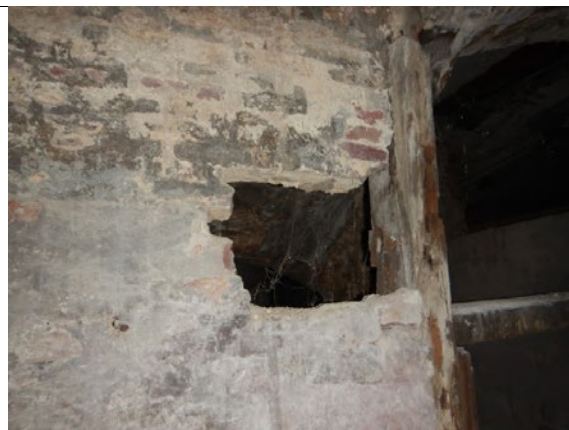
Foto 8: scheidingswand ruimte 1 en 2 ontbrekende stenen
