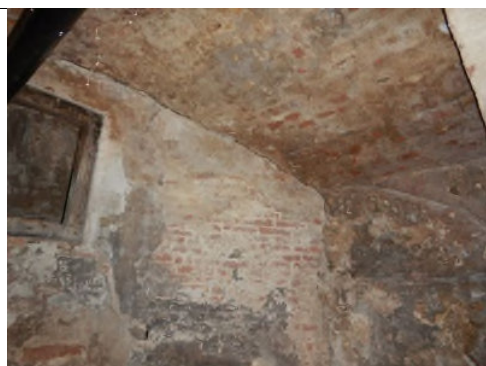
Foto 7: vochtige plekken kelder 2
