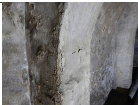
Foto 8: stucwerk laat los kelder 2
