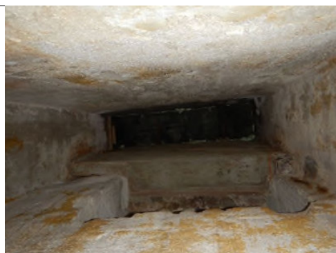
Foto 1: Luik en lekkage kelder 1
