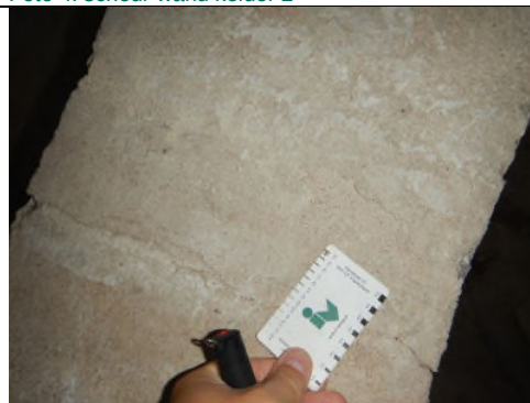
Foto 6: scheuren in rib kelder 2
