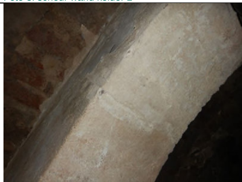
Foto 5: scheuren in rib kelder 2
