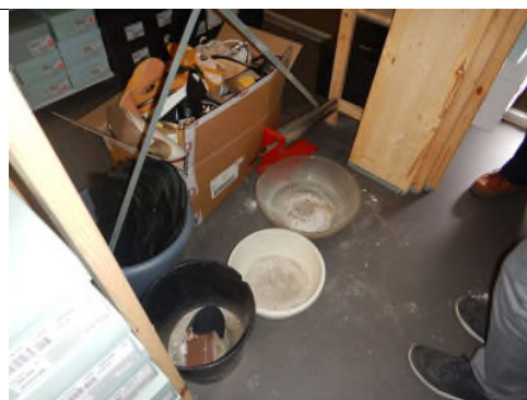
Foto 2: Luik en lekkage kelder 1
