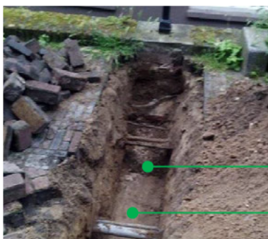
Foto nr. 4 geen betonfundatie over gewelf
