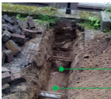
Foto nr. 4 geen betonfundatie over gewelf
