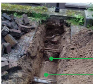
Foto nr. 4 geen betonfundatie over gewelf
