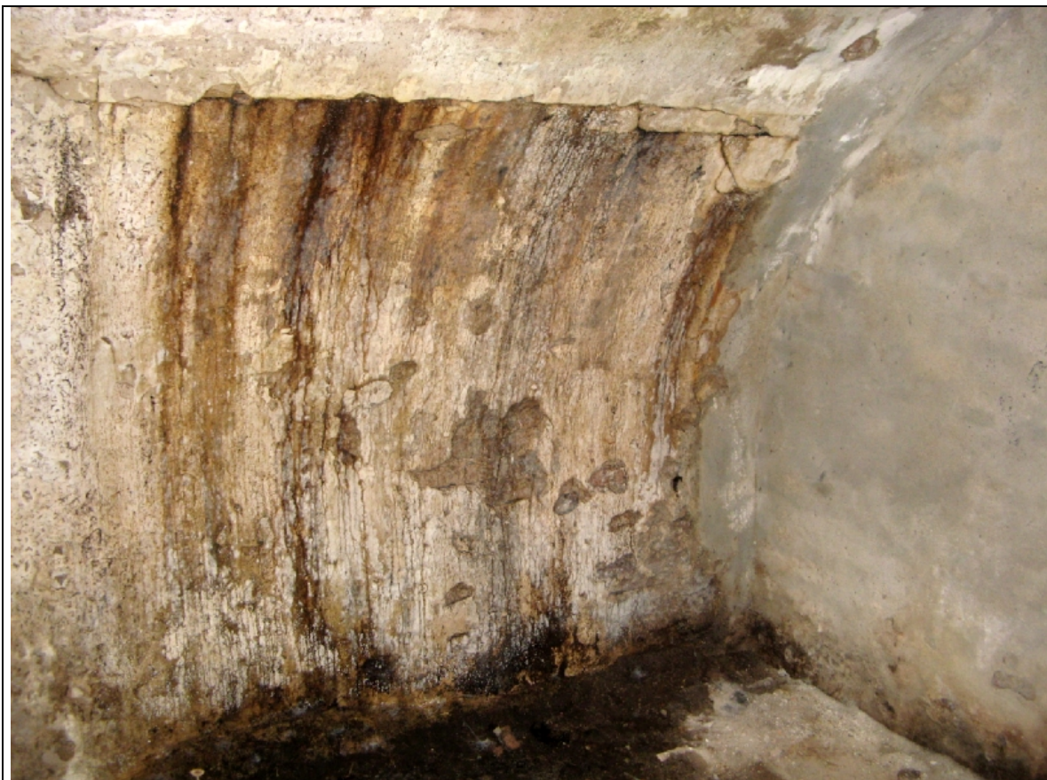
Foto 5: Linker wand heeft scheur met lekkage
