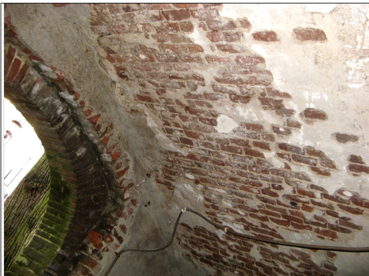
Foto 4: Eerste meter gewelf compleet lek.
