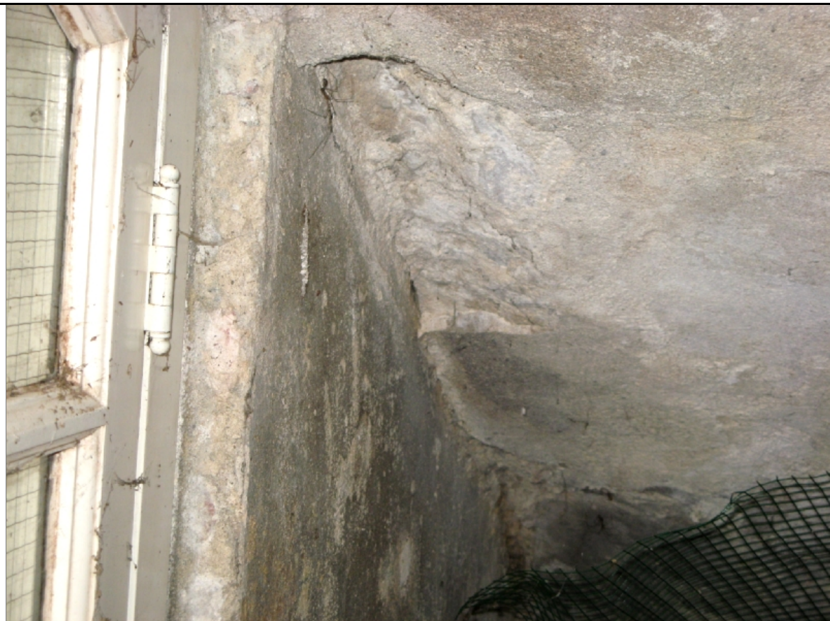
Foto 5: Lokaal aansluiting gewelf/muur gescheurd.
