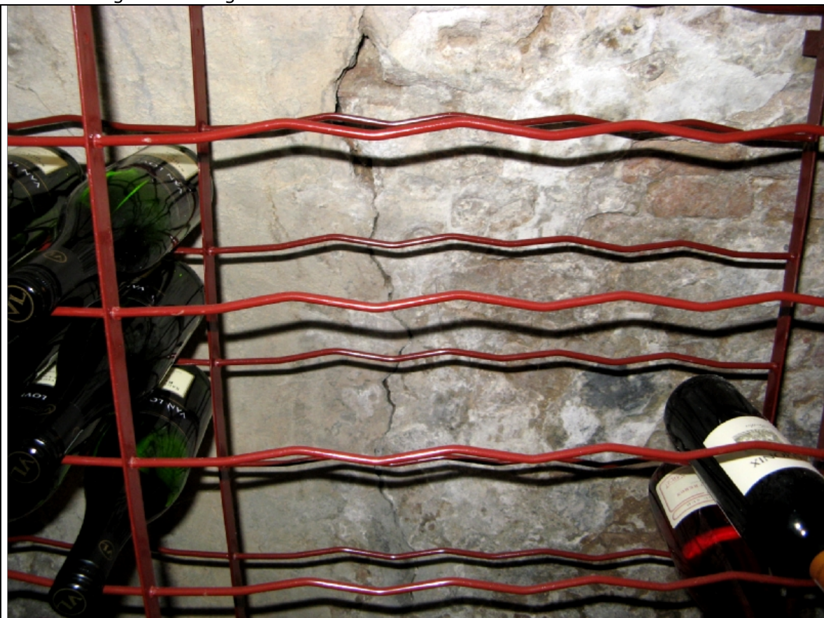
Foto 8: Scheur in wand rechts.
