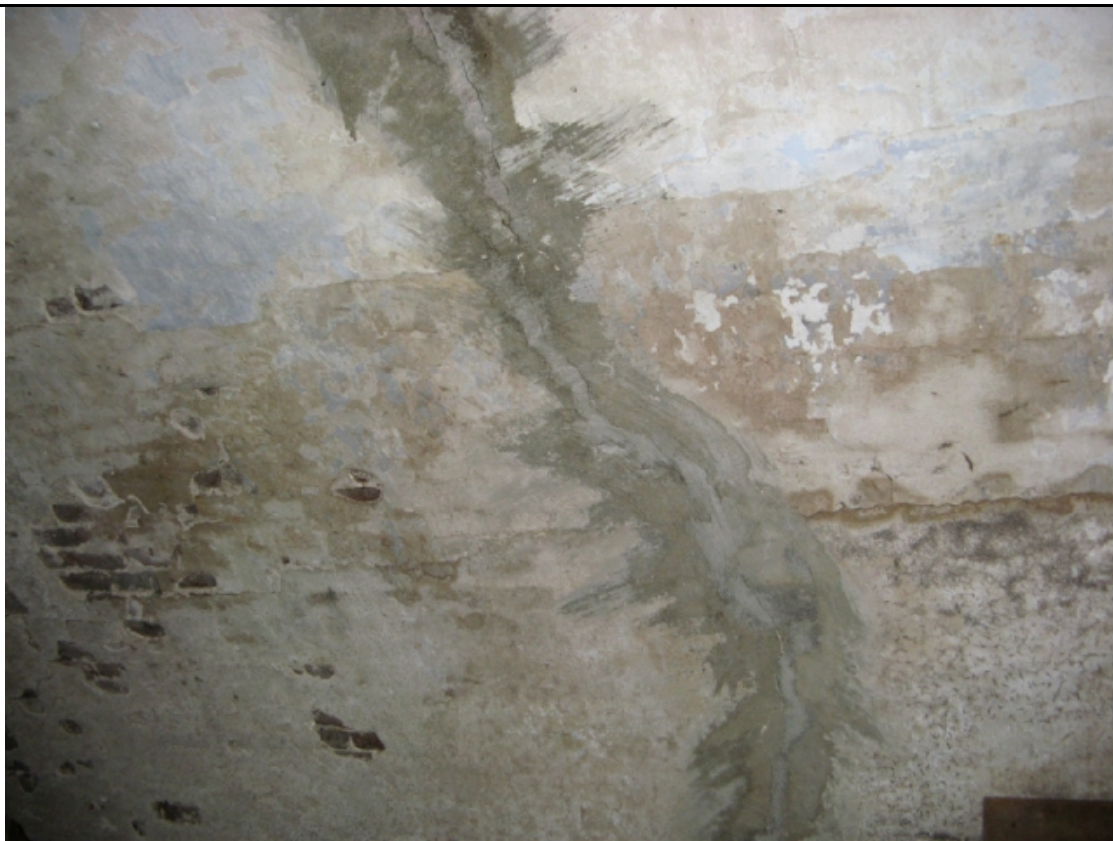
Foto 5: Gerepareerde scheur dwars over de hele kelder
