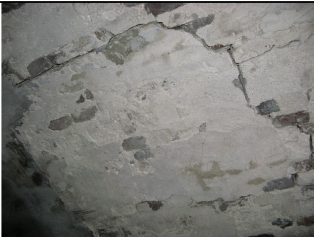
Foto 7: Een losse metselwerkschijf in gewelf
