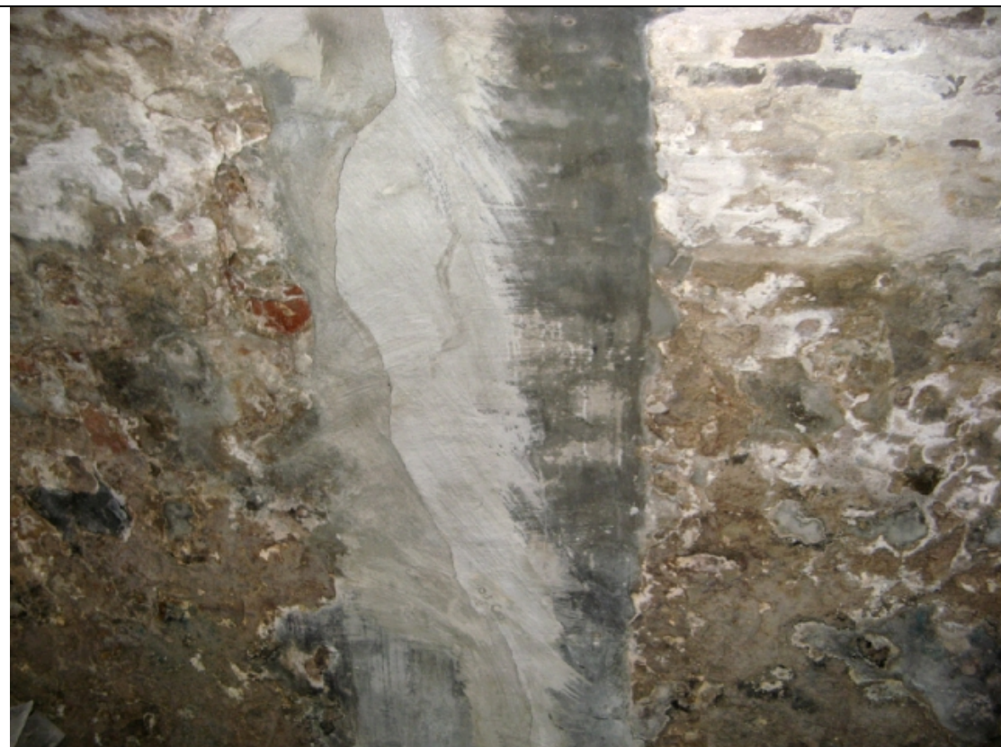
Foto 6: Gerepareerde scheur dwars over de hele kelder
