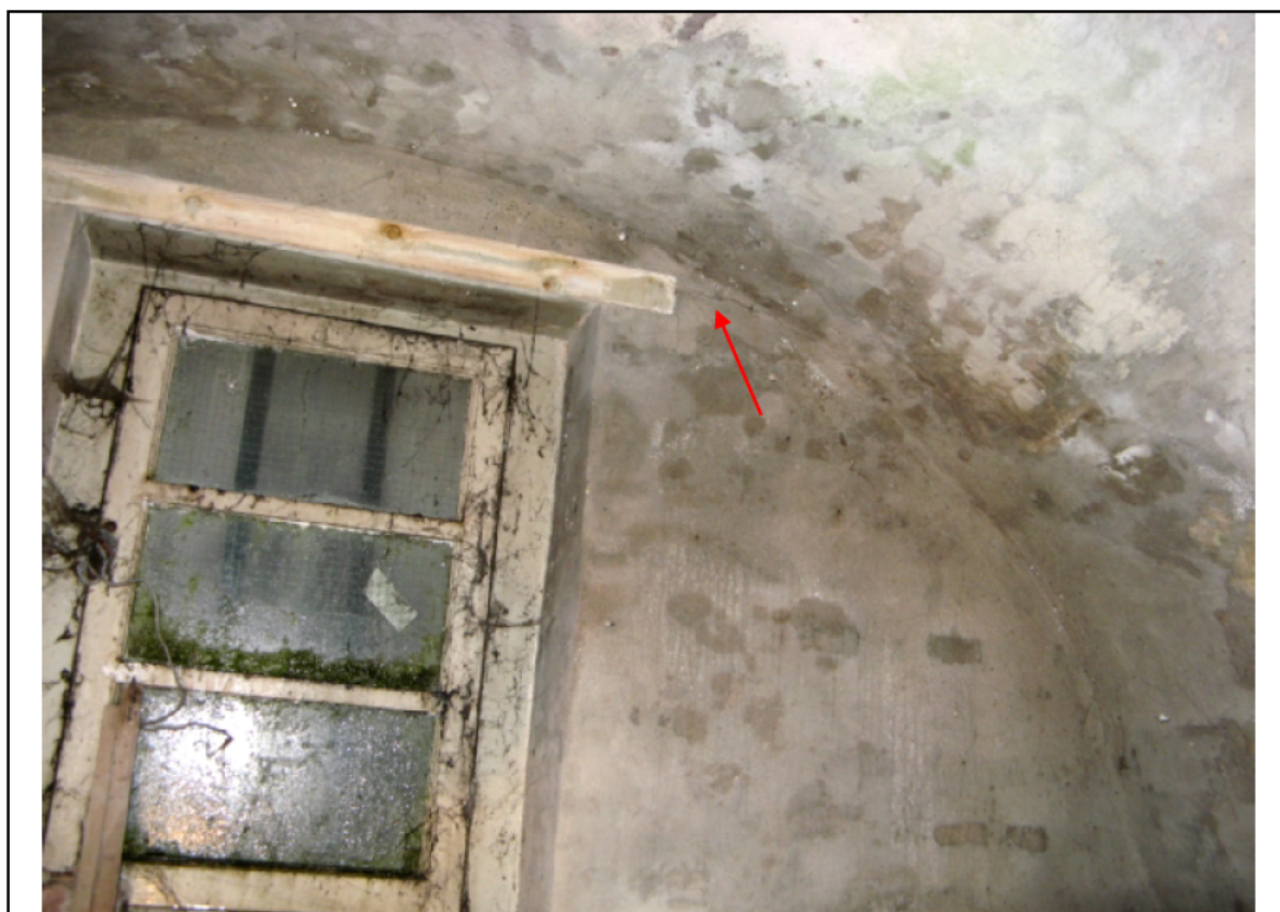
Foto 4: Lichte scheur aan binnenzijde werfmuur
