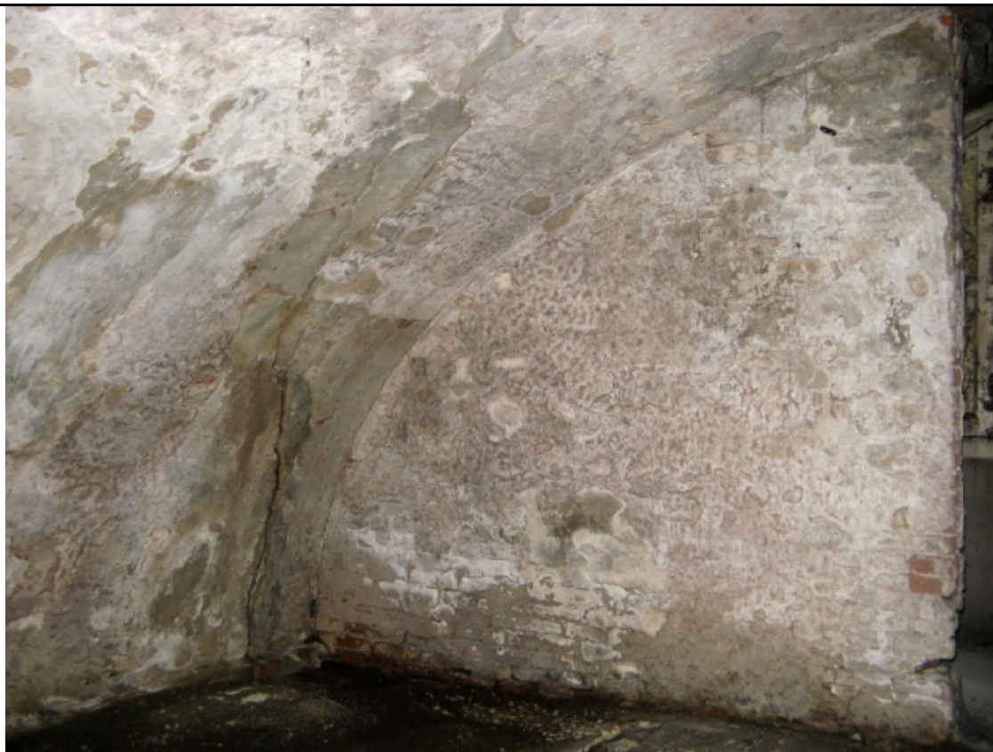
Foto 5: Begin van dwarsscheur (net na de eerste meter kelder vanaf waterzijde)
