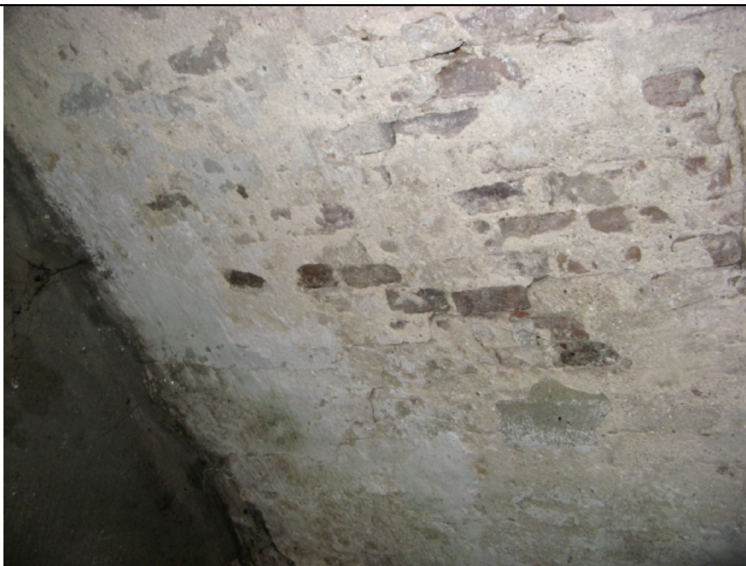
Foto 11: slecht stucwerk, lichte scheuren in gewelf
