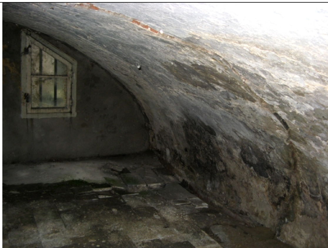
Foto 6: A) Einde scheur in rechter* wand (ca 4,5m uit werfmuur) B) Scheurranden zijn verschoven t.o.v. elkaar, twee losse gewelven liggen niet in een vlak
