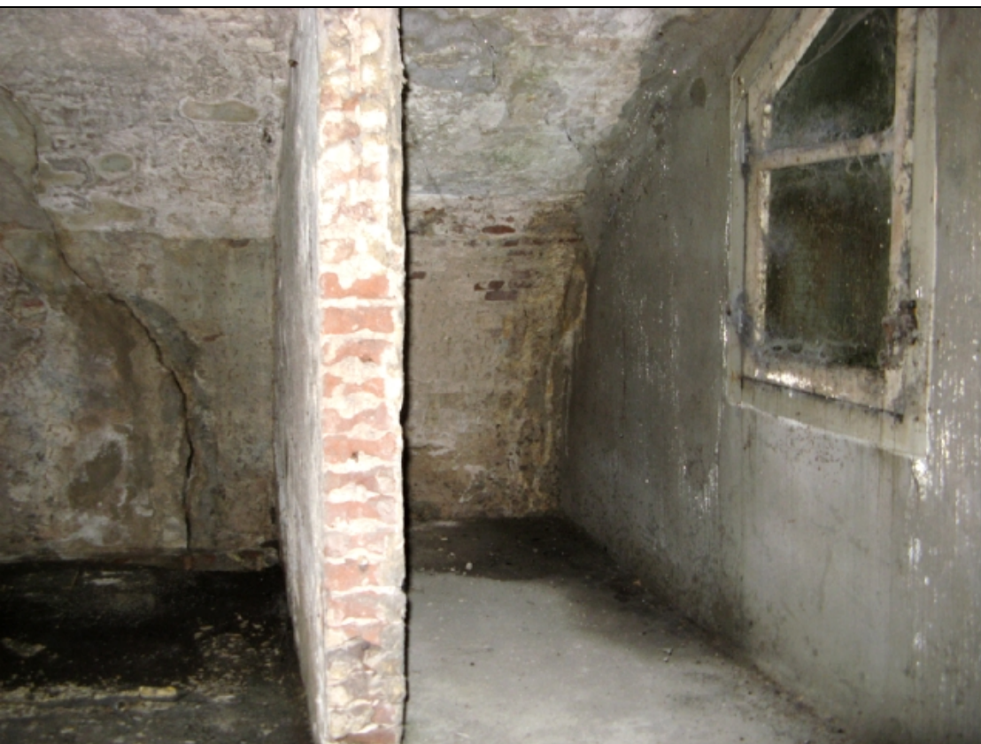
Foto 4: Toestand eerste meter kelder: lichte scheuren in gewelf en matig stucwerk
