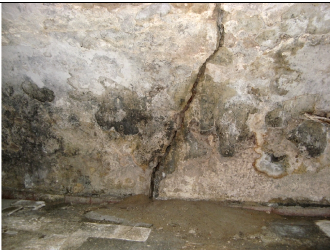
Foto 7: Scheurwijde plaatselijk ca. 30mm, uitgespoeld zand
