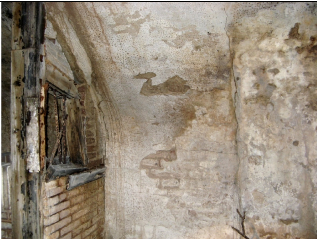
Foto 7: scheur(en) in gewelf en linker wand
