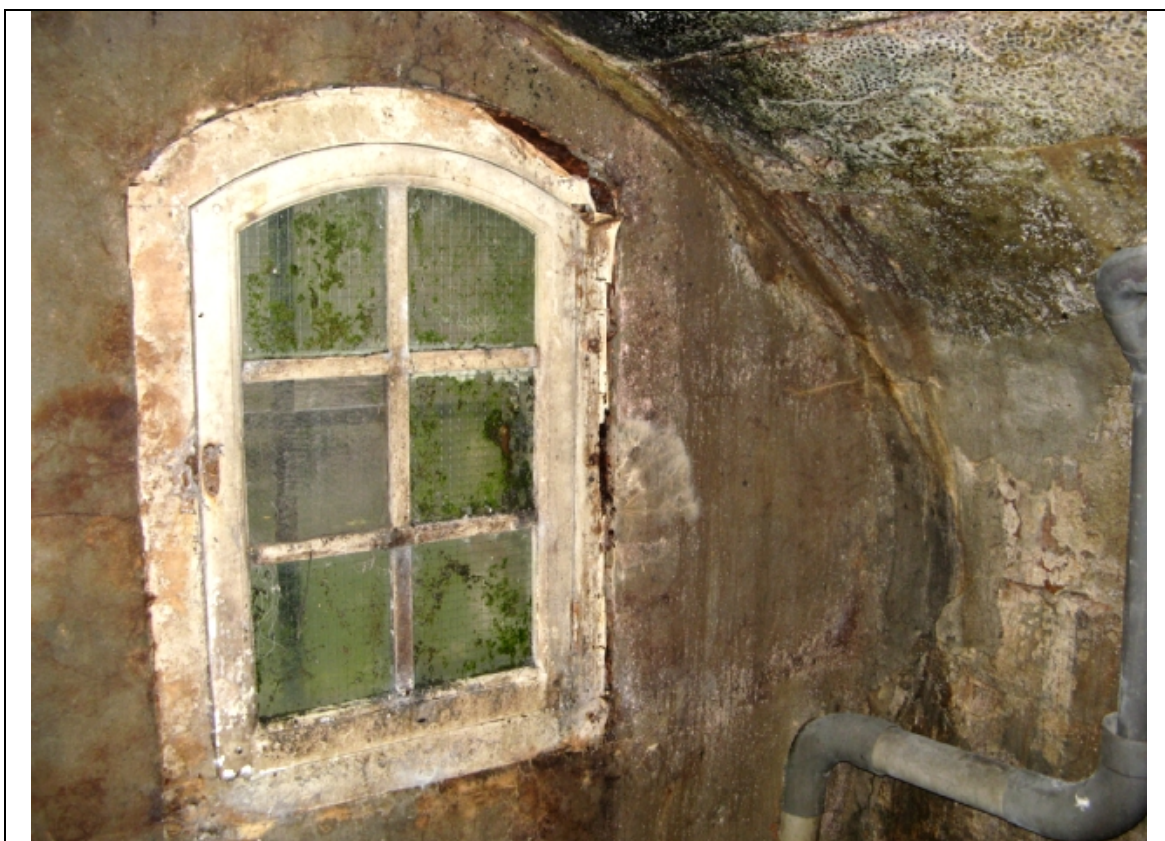
Foto 4: Lengtescheuren en vochtplekken in gewelf, aansluiting los
