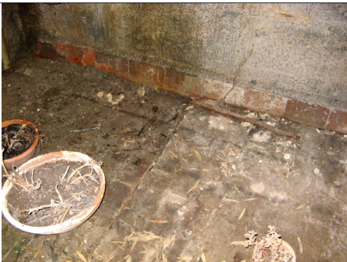
Foto 10: scheur(en) in vloer en rechter wand
