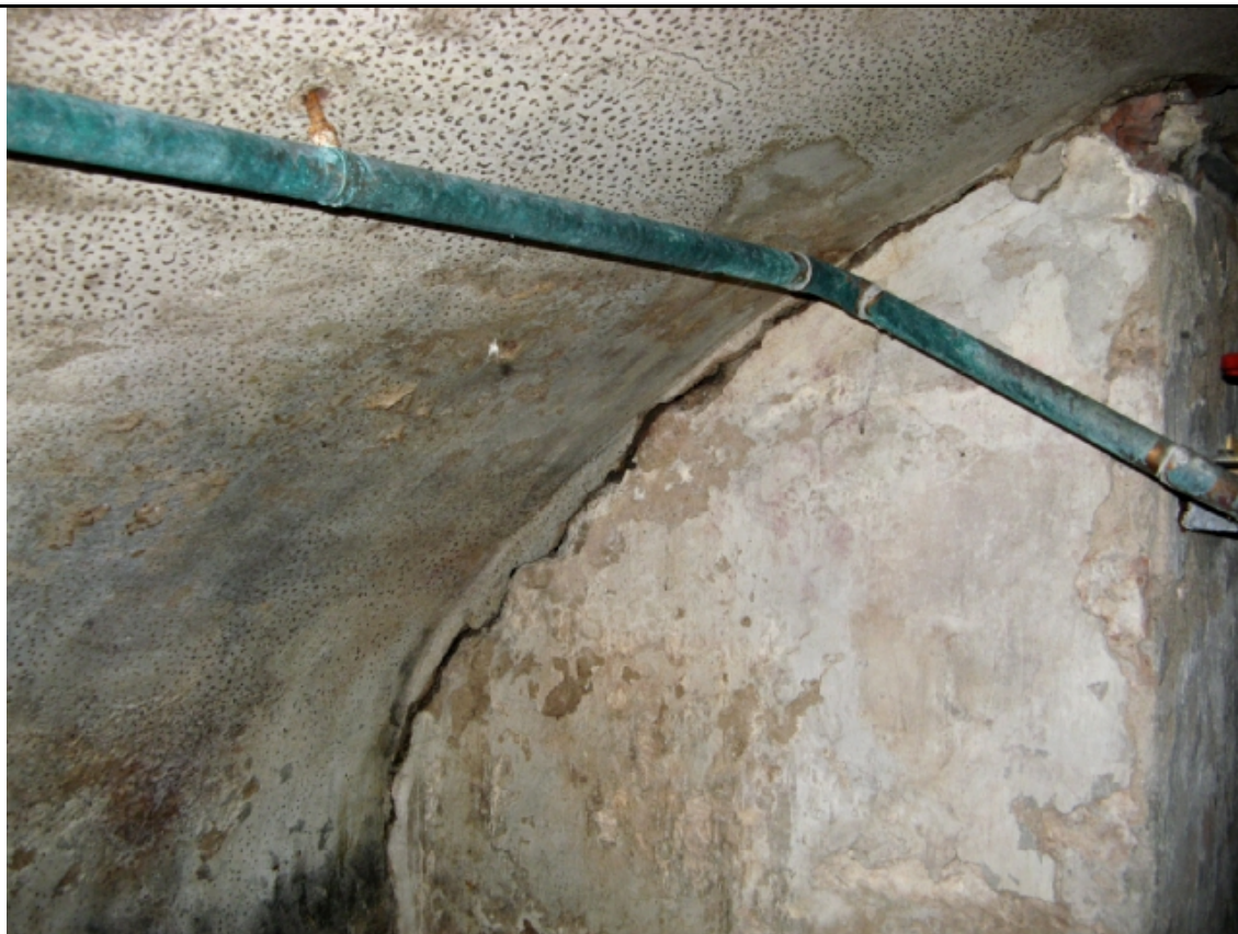
Foto 11: scheur(en) in aansluiting gewelf/ achterwand
