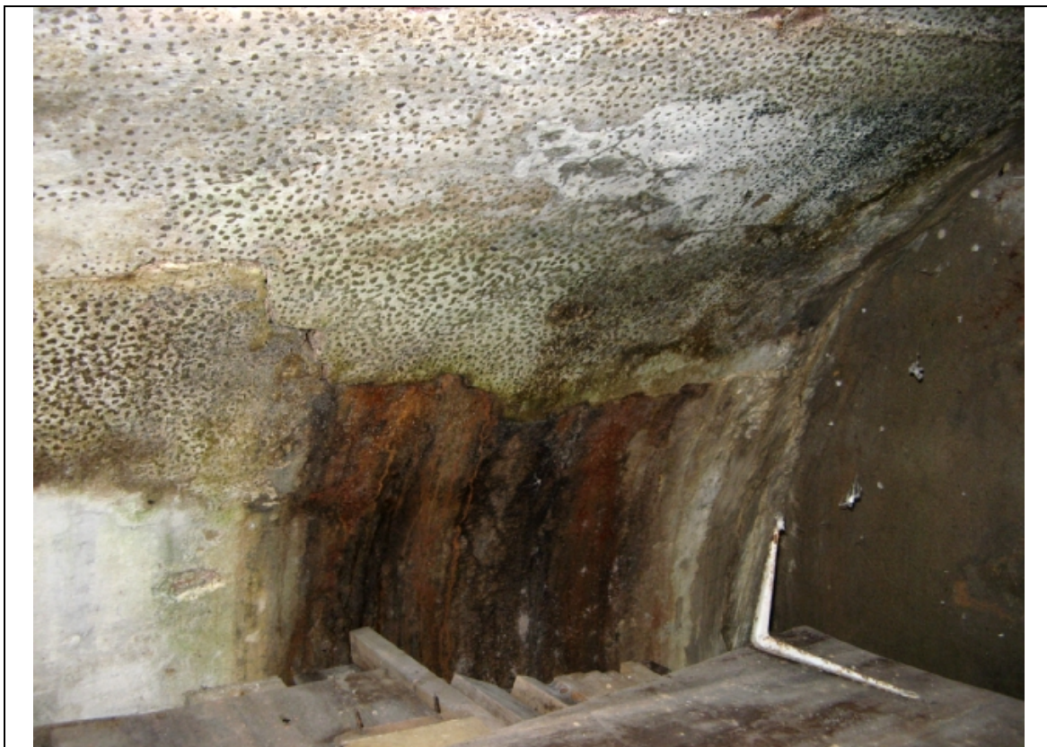
Foto 5: : Lengtescheuren en vochtplekken in gewelf, aansluiting los
