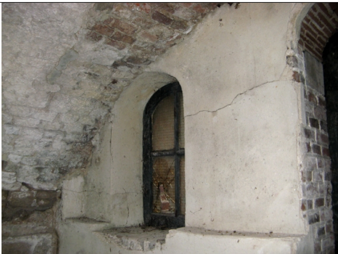
Foto 4: Diverse scheuren in gewelf en werfmuur
