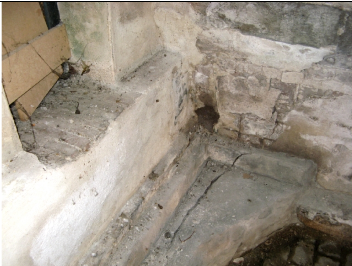
Foto 7: Scheur in rechter wand en deels in vloer
