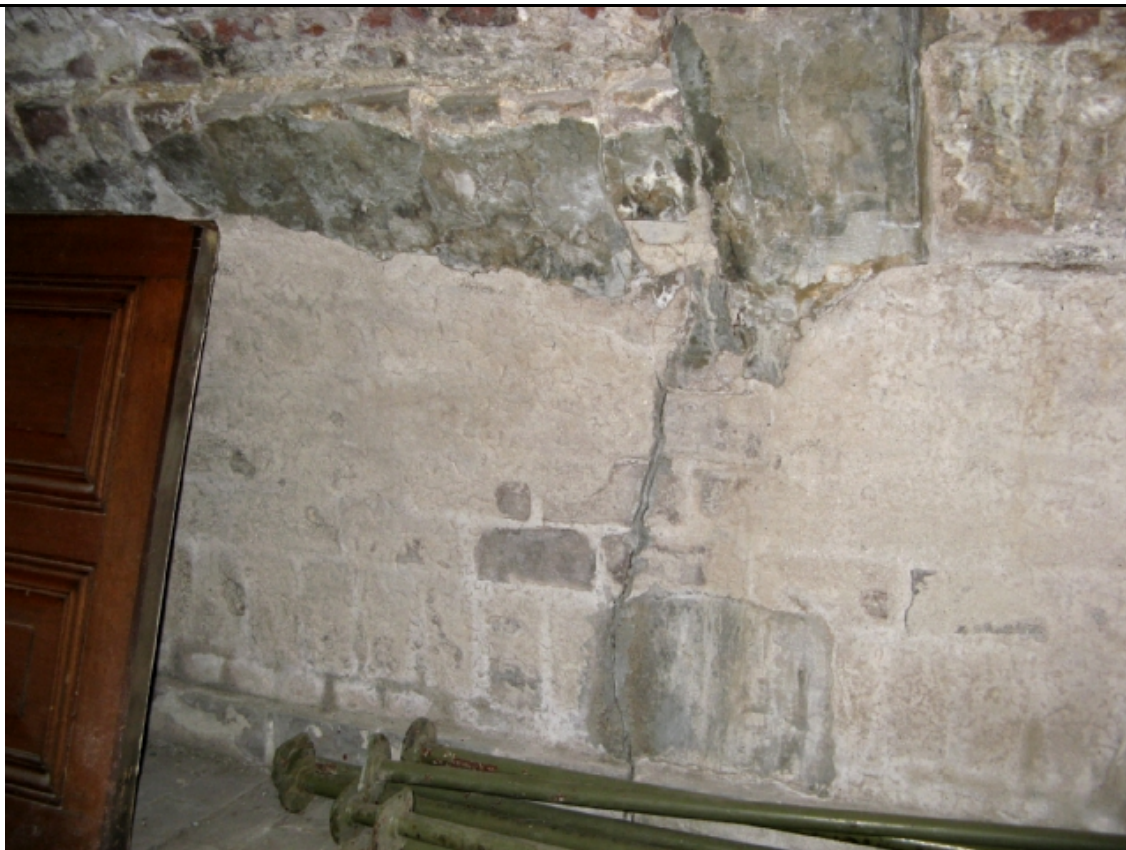
Foto 9: Dwarsscheur in rechter wand en gewelf
