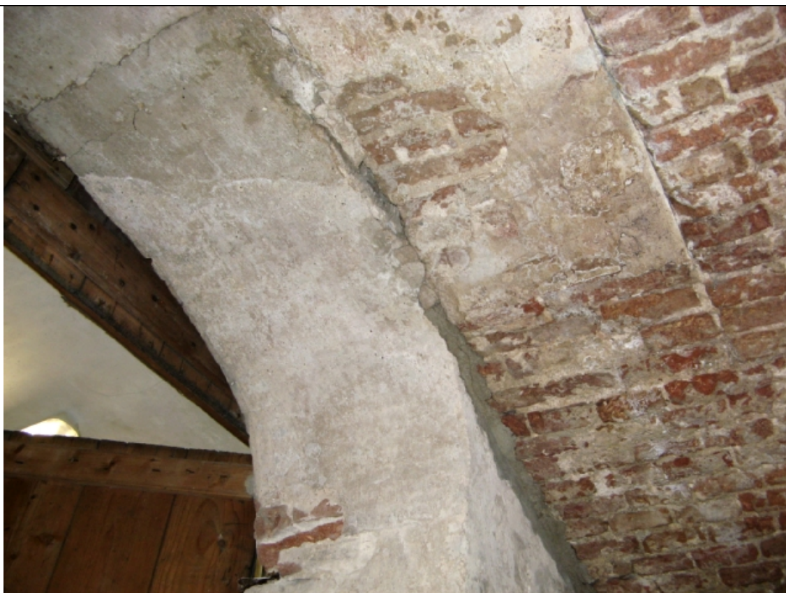
Foto 12: aansluiting met achterwand: los
