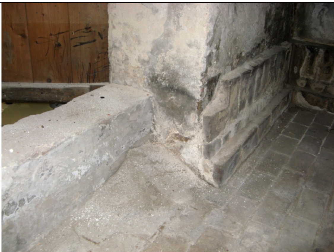
Foto 13: Zanduitspoeling (in het verleden!?)
