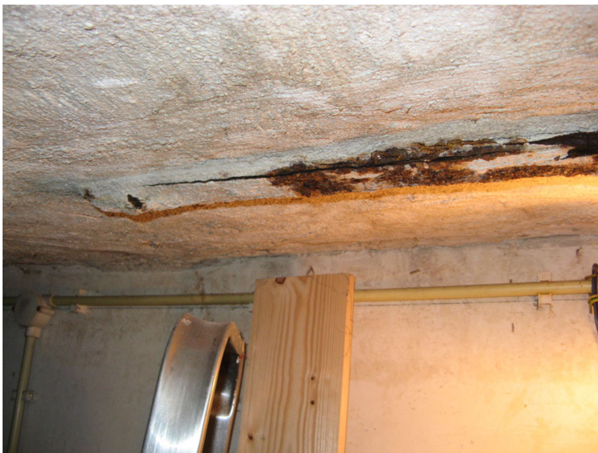
Foto 7: Gecorrodeerde muurankers, functie vervallen.
