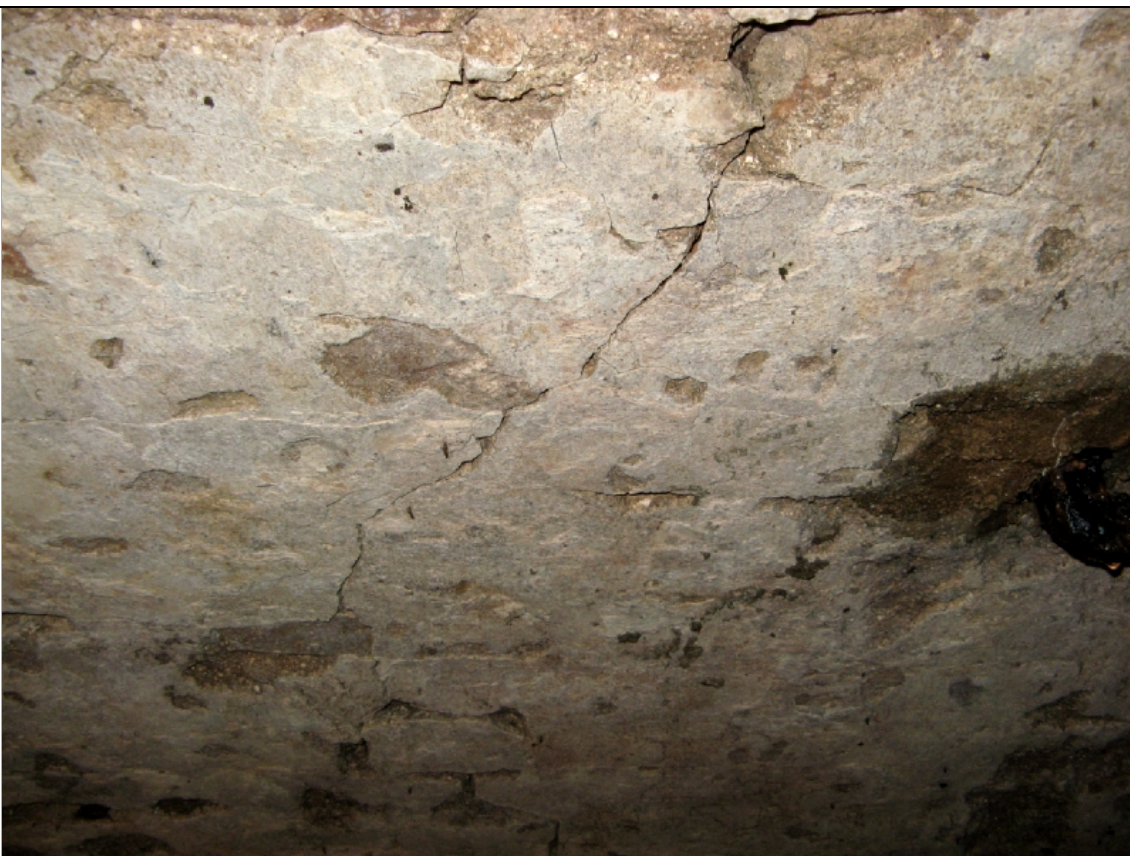
Foto 6: Veel scheuren en ontbrekend metselwerk in gewelf.
