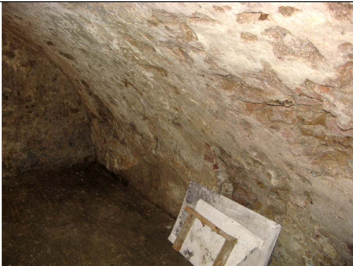
Foto 7: Scheuren en ontbrekend metselwerk.
