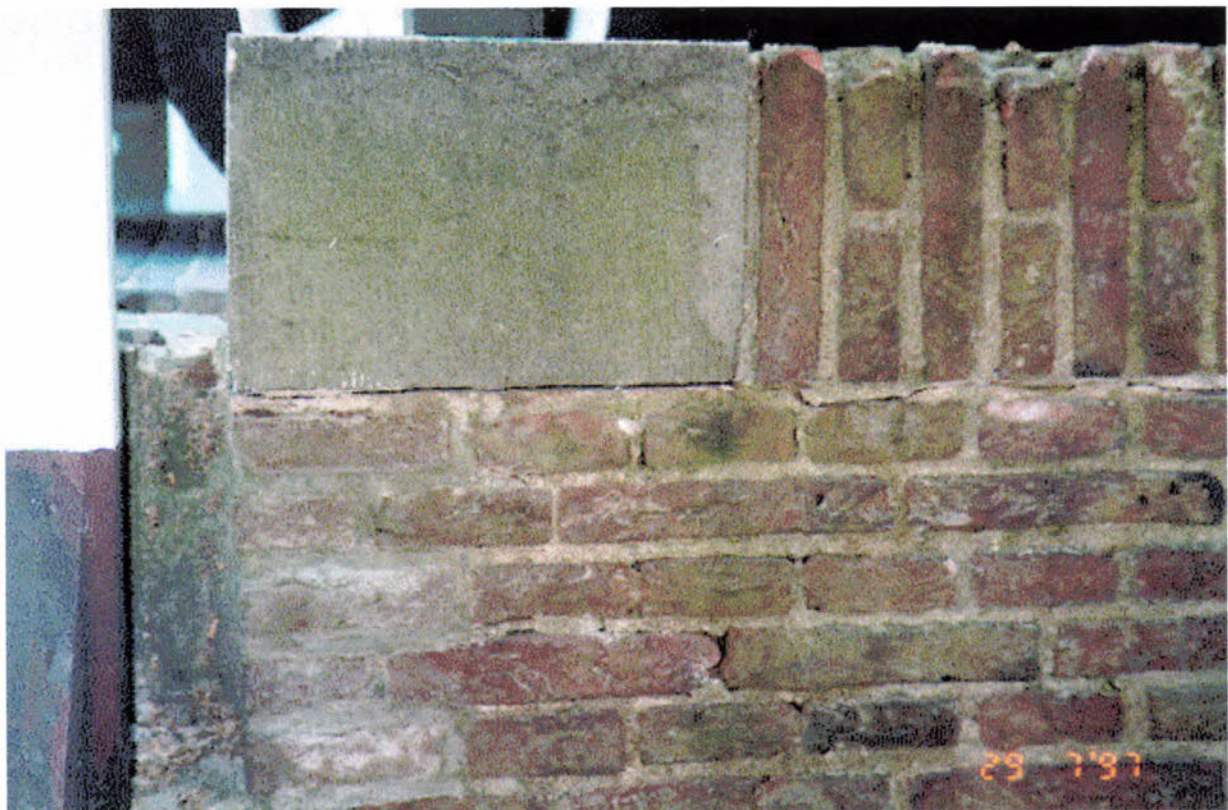
W0274-02 Scheur in metselwerk onder rollaag en balieblok
